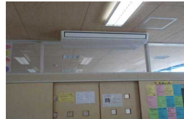
【設置されたクーラー】
